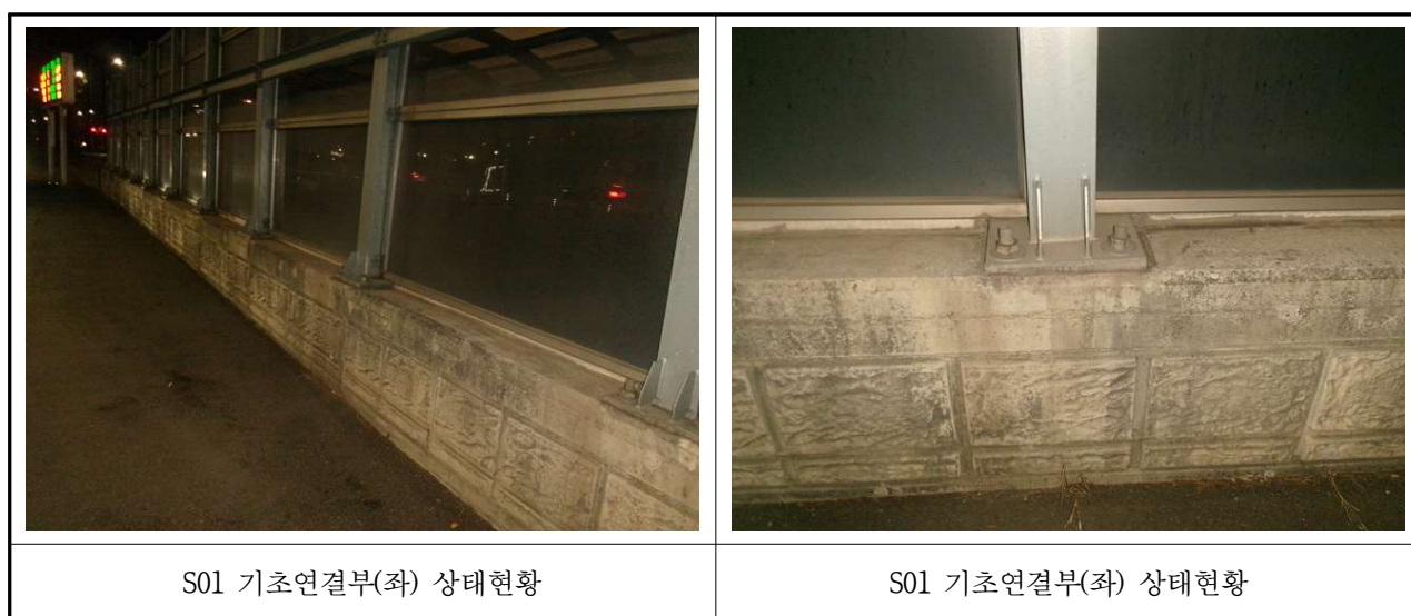
【사진 3.4.6】 기초연결부 손상현황
