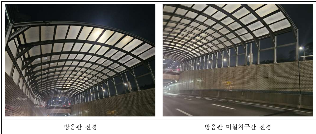
【사진 3.4.9】 방음판 전경
