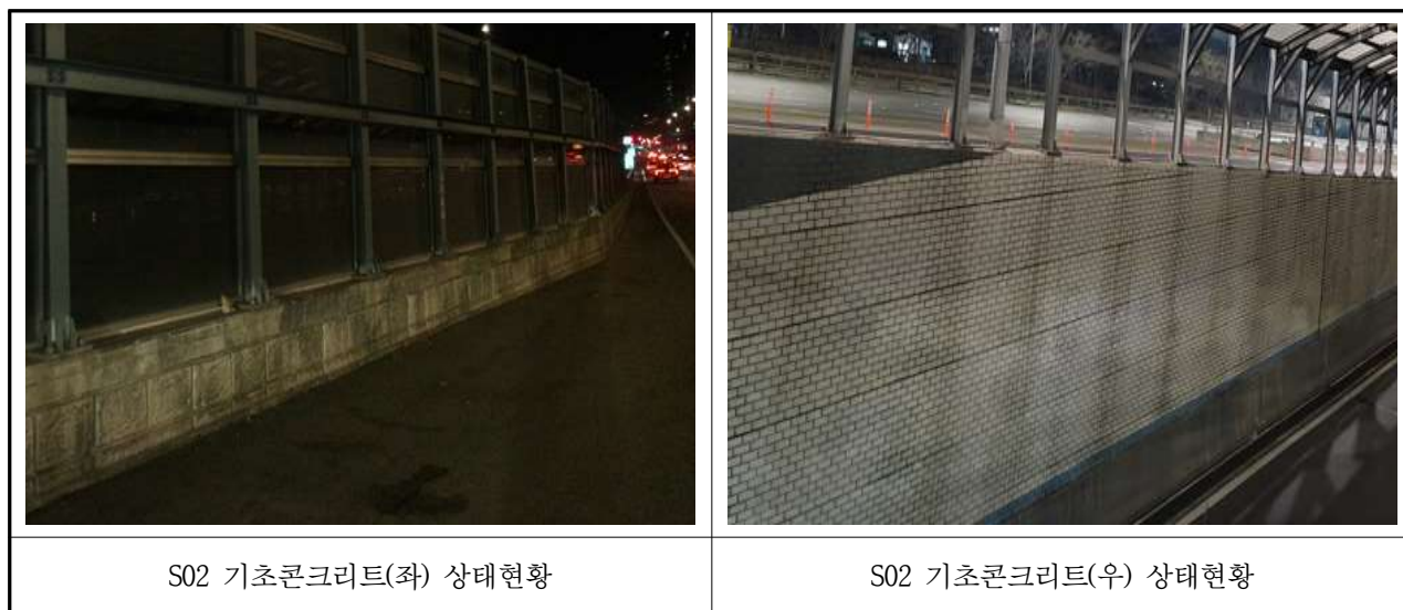
【사진 3.4.8】 기초콘크리트 손상현황(계속)
