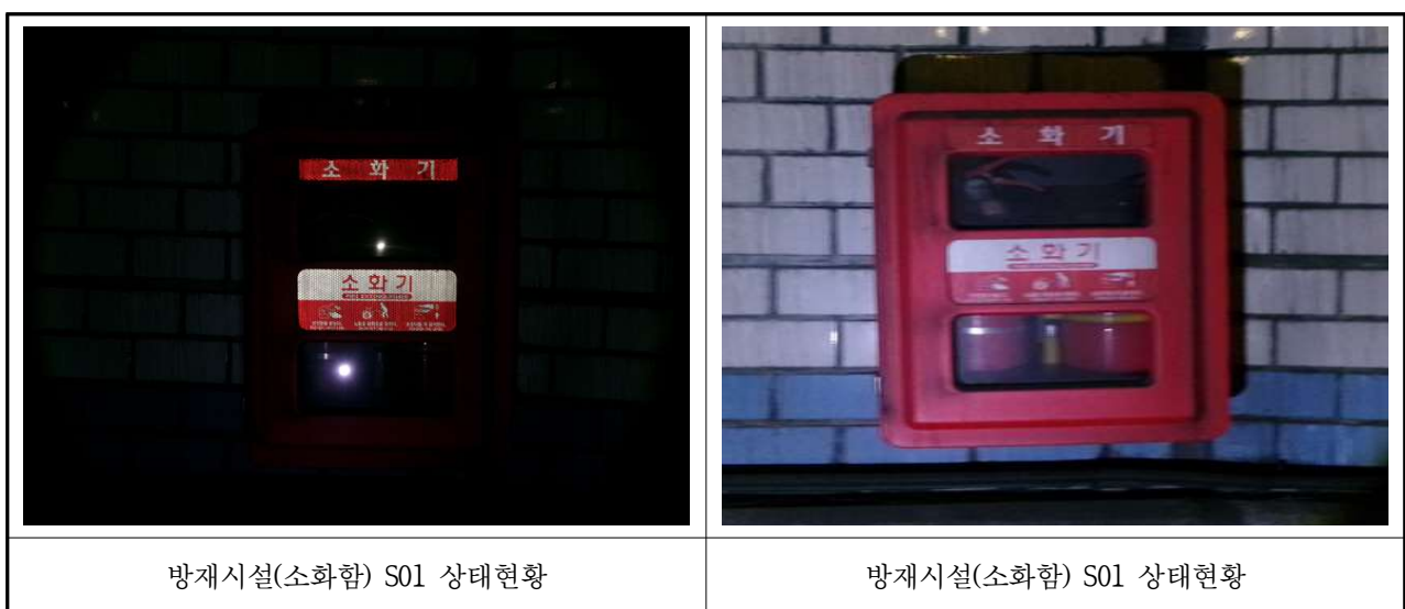
【사진 3.4.17】 방재시설 손상현황
